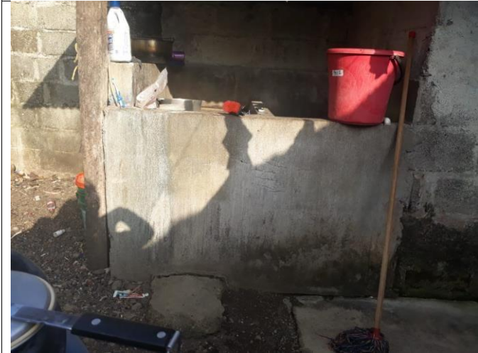
Estado actual de poceta
