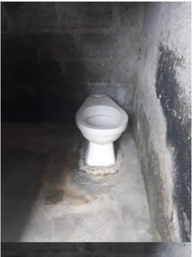
Baño en mal estado
